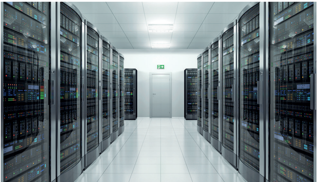
Conceito informático moderno de redes e telecomunicações: sala de servidores em datacenter .
