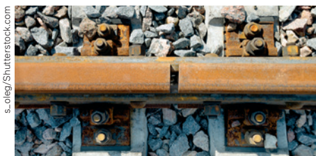
Junta de dilatação em trilho de trem.
