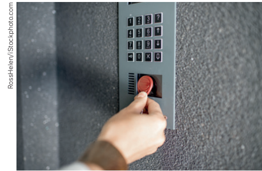
Tag sendo utilizada para abertura de trança em portaria.
