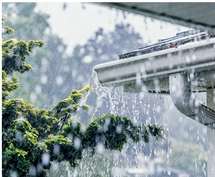
Água da chuva escoando de um telhado. Estados Unidos, julho de 2018.
